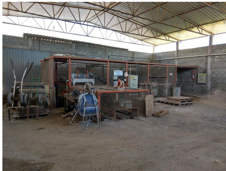
Figura 3- Revestimento de segurança da prensa hidráulica com telas de aço.
