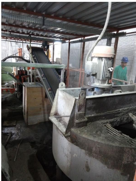
Figura 1- Vista do misturador e esteira de transporte
