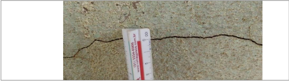
Figura 6. Exemplo de uma trinca.
