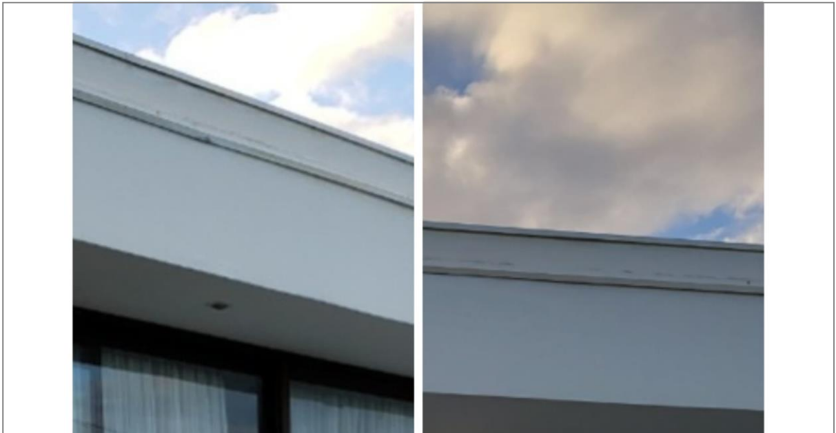
Figura 09. Abertura das fissuras na fachada.
