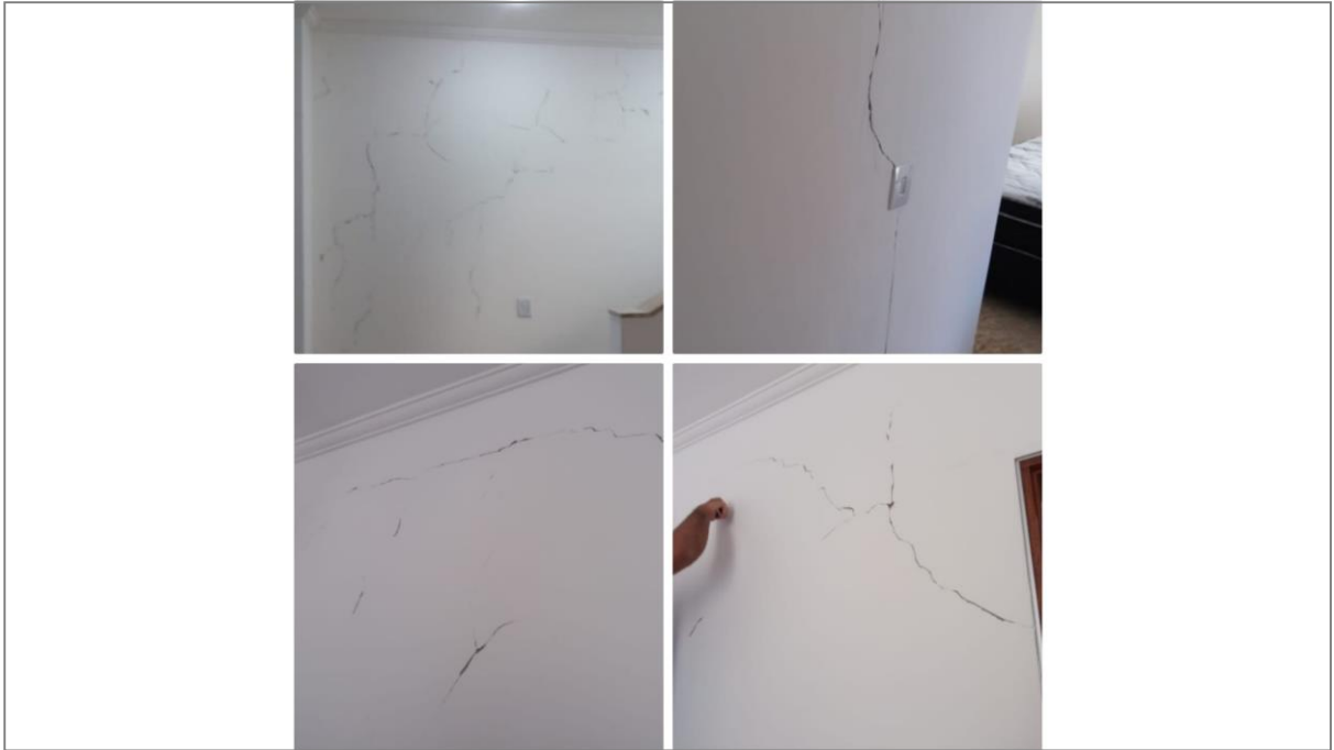
Figura 08. Abertura das fissuras internas da residência.
